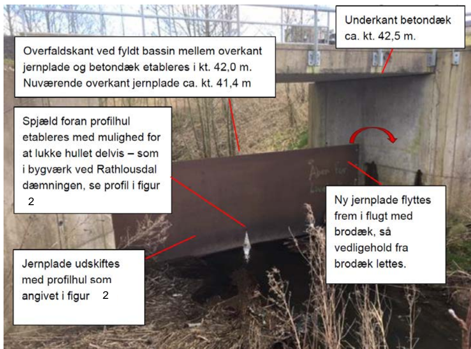
Figur 1. Foto af eksisterende jernplade i bygværk. Pladen udskiftes og monteres i flugt med front af brodæk. Det nye profil bliver 0,4 m højt og 1,2 m bredt. Overfaldskanten ligger i kote 42,2 m mod 41,1 m på den eksisterende.
